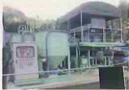
写真 処理設備の例
