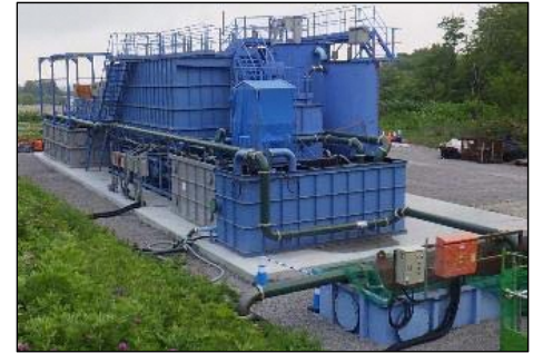
写真 濁水処理設備の例
