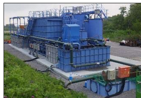
写真 濁水処理設備の例
