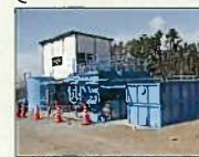
写真 濁水処理設備の例
