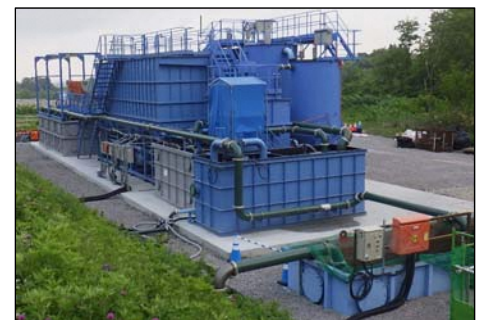
写真 濁水処理設備の例
