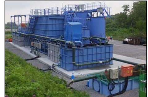
写真 濁水処理設備の例
