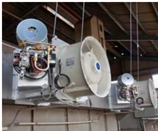
導入機械 (ガス直火型熱風発生装置)
