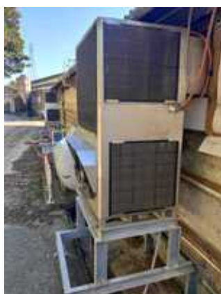
図1 空調機の外見
