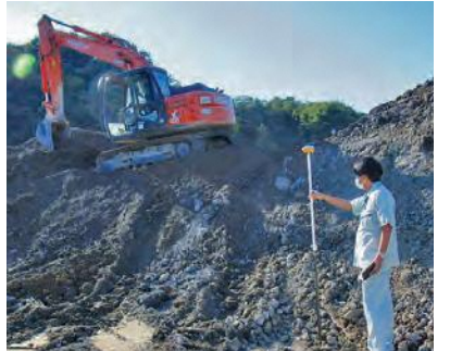
盛り土110番への通報を受け現地を確認している様子
