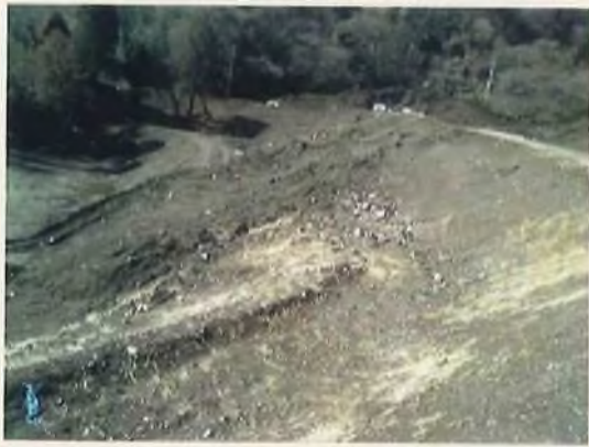
② 崩壊している法面の状況
