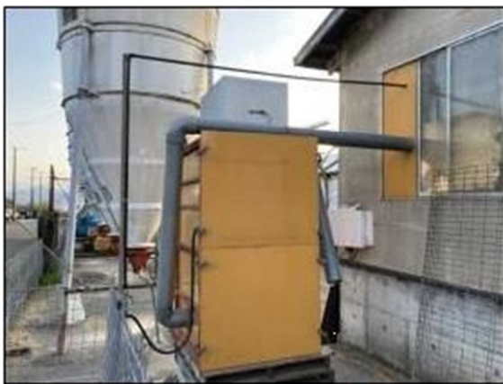
写真6 脱臭装置の外観
