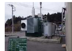
バイオマスプラント発電機
