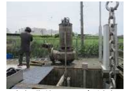
老朽化施設の緊急対応
