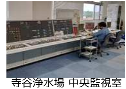
寺谷浄水場 中央監視室
