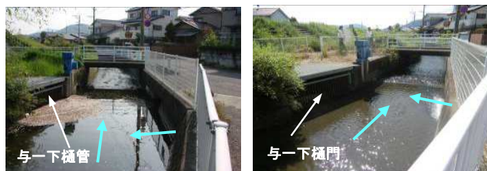
図-2 与一下樋管（左：取水時 右：転倒時）
