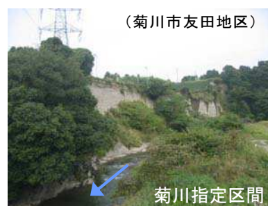
図 1-4 切り立った河岸の状況
