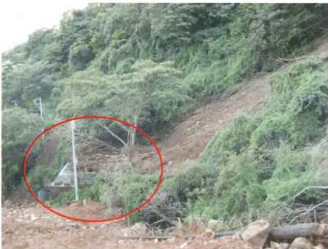
崩壊地下部 熱海市水道施設
