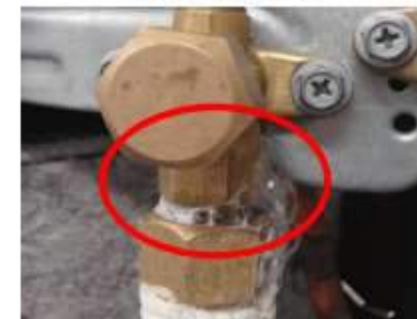
点検による漏れの確認
