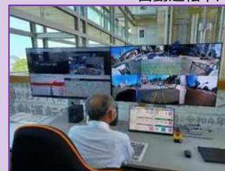
遠隔監視の状況（掛川市役所）
