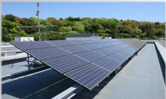
太陽光発電パネル（屋根置き）
