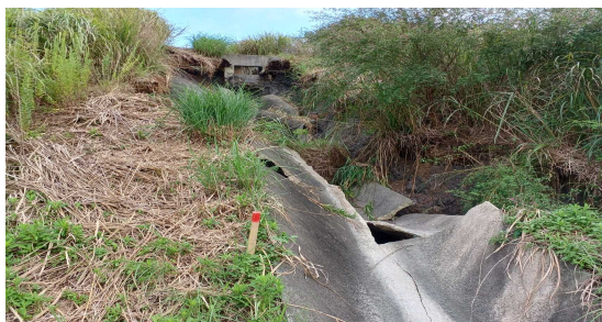
排水施設破損
