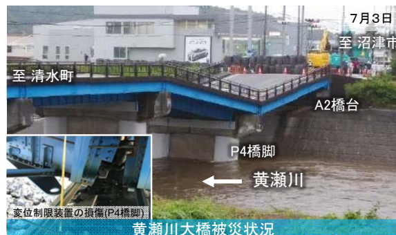
黄瀬川大橋被災状況
