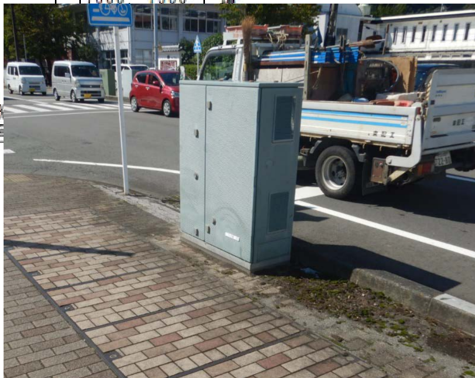
電線共同溝の地上機器
