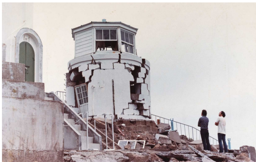
大破した石廊崎灯台
