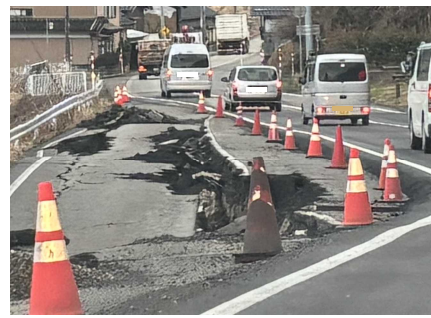
道路被害状況
