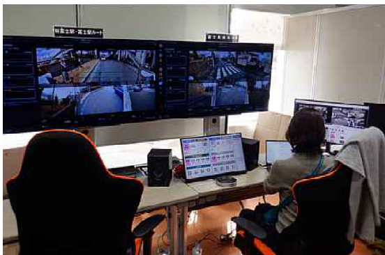
遠隔コントロールセンター（監視の様子）
