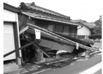
(平成19年 新潟県中越沖地震の被害)
