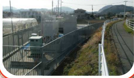
旭台排水機場のポンプ増強（平成19年度完了）
