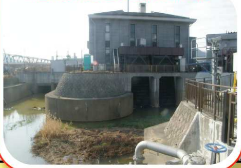
四日町排水機場のポンプ増強 (平成20年) ※この対策は国土交通省が実施します
