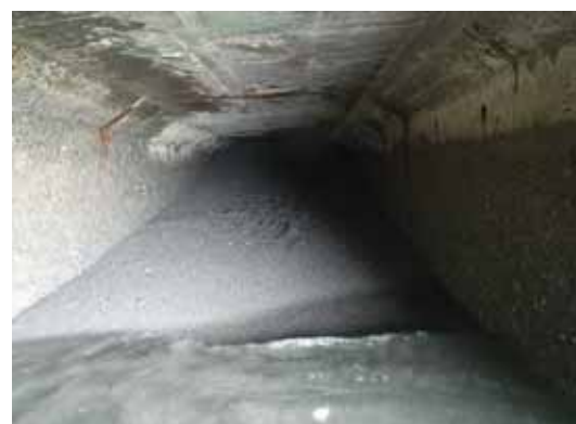
図 2.10 沼川第2放水路の閉塞状況 (手前の海側から暗渠内部を撮影)
