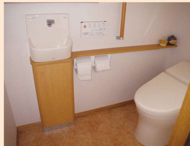
便所のバリアフリー工事 耐震補強工事と併せて便所のバリアフリー工事(床の段差解消、手摺の設置)を行いました。
