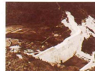
萩間川水系 菅ヶ谷川(牧之原市菅ヶ谷) 昭和27年度砂防工事
