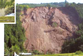
崩壊発生後斜面状況
