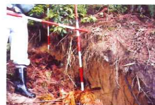
地すべり頭部の段差状況
