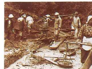
伊佐地川(浜松市中央区湖東町) 昭和25年度砂防工事の実施状況
