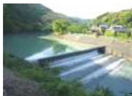
太田川上流用水 (三倉頭首工、森町) 水田 451ha
