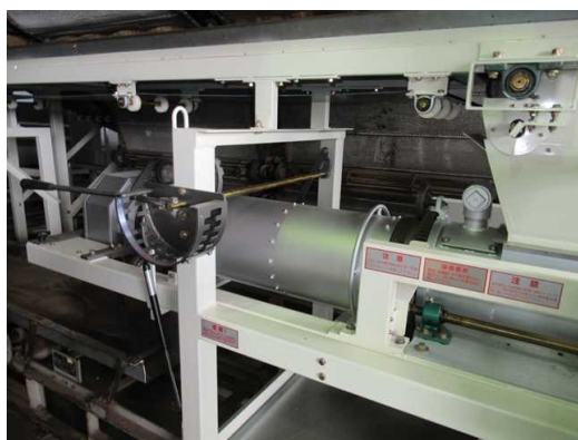
ドリンク向け製茶機械施設整備
