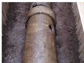
老朽化した管水路
