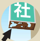
側板底面の腐食、破損
