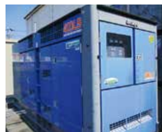
非常用の発電機
