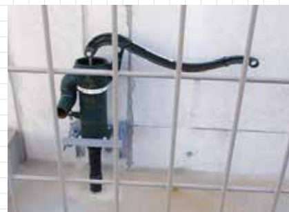
災害時ライフラインとして使用できる工場横の井戸水
