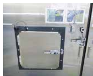
冷凍倉庫扉の脱出用小窓
