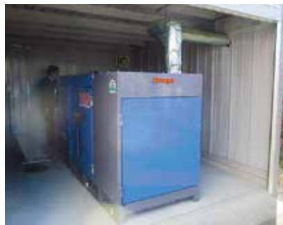
150kwのディーゼル発電機
