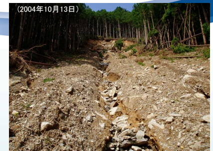
崩落面の侵食痕
