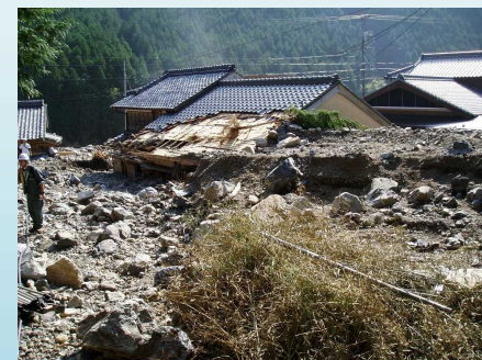
松原地区の土砂流出(溪流沿い)
