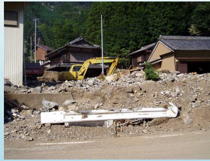
松原地区の土砂流出(国道沿い)
