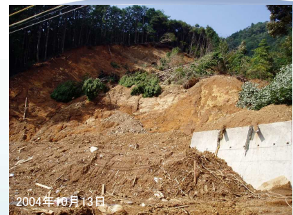
崩壊斜面と残存する擁壁(左側は流失)
