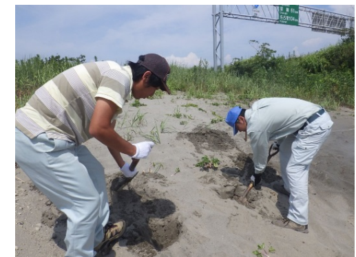
砂法面に植生を復元する方法を検討 (工事地内のハマボウフウを移植)
