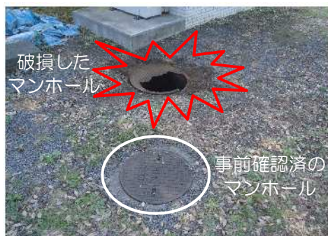
マンホール蓋の破損状況
