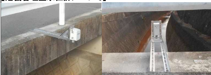
写真は2018年度に設置した水位計は、全てこの機種
