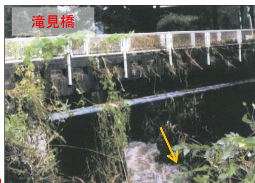
H19.9台風被災状況
