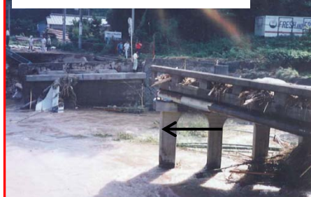
(国) 414号志戸橋の落橋状況
