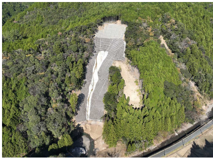
▲崩壊地の復旧（森町三倉）
