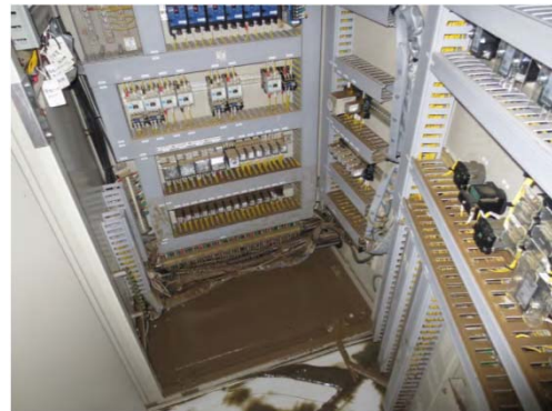
豪雨により配電盤が浸水
