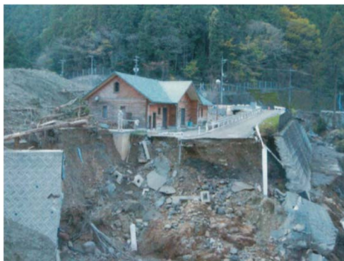
集落排水施設が河川の増水で被災
