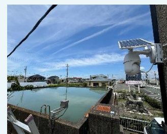
遠隔監視システム
