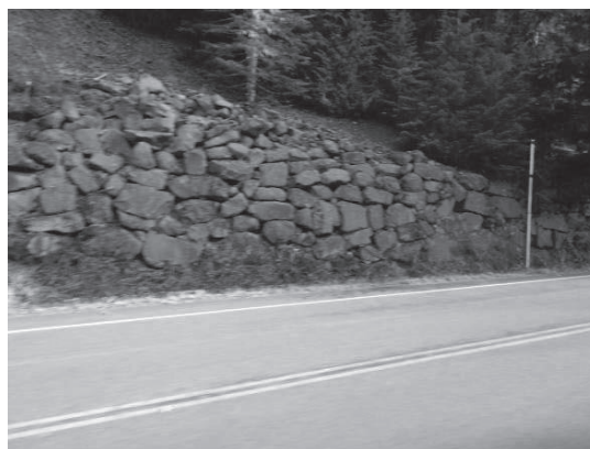
ガードレールはなく、現場の石積みで代用
