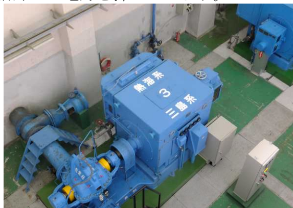
駿豆水道 中島浄水場 送水ポンプ
