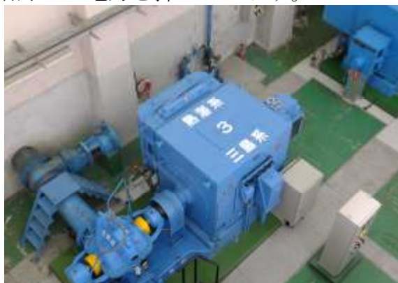
駿豆水道 中島浄水場 送水ポンプ
