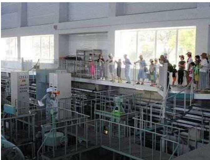
中継ポンプ室見学の様子
