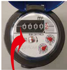
水道メーターのふたを開けて、この部分（パイロット）を確認してください
