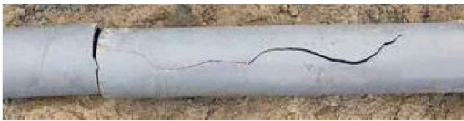
▲劣化により裂けてしまった水道管
