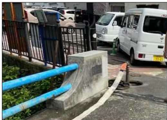
湯河原側側排泥口
