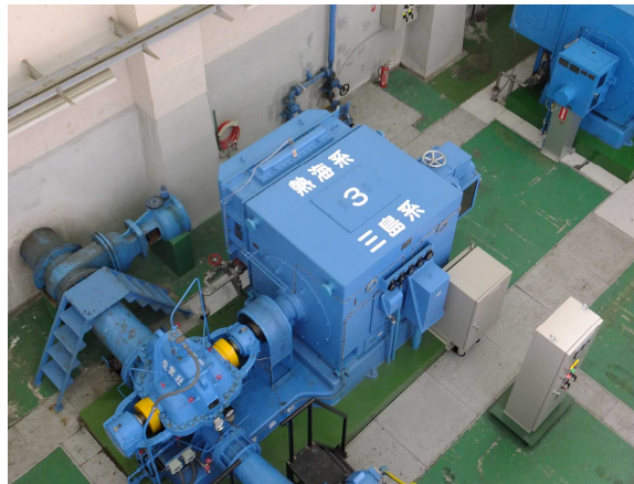
駿豆水道 中島浄水場 送水ポンプ
