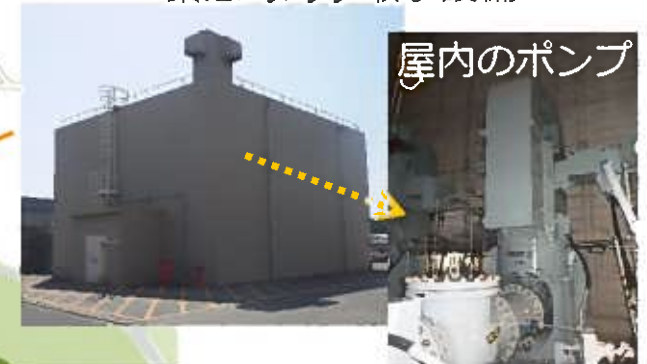
緊急時海水取水設備
