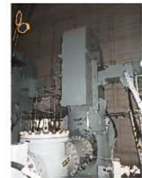
屋内の緊急時海水取水ポンプ
